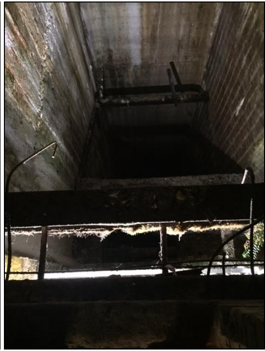
Schacht Fahrstuhl ausgebrannt
